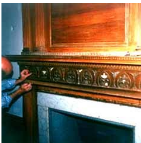
Um conservador substituiu peças partidas de ornamentação em " compo " numa moldura de lareira durante uma obra de restauro. Fotografia : Cortesia de Irving Haynes and Associates.
