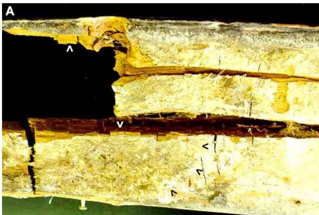
Figura A – Serpulla Lacrymans (podridão seca). A imagem mostra parte de uma porta interior com uma podridão seca extensa. A madeira apodrecida parece partida em tijolos (setas brancas), o que é típico deste fungo. À esquerda, em baixo, podemos ver o espalhamento das hifas deste fungo, de cor amarela enxofre, sobre a superfície da madeira – o limite do seu avanço está indicado pelas três setas pretas.
