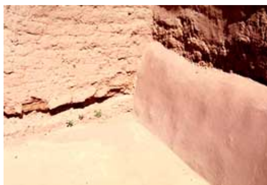
O “tunelamento” na base desta parede em adobe pode ter sido provocado pelos sais depositados pela água ascendente do terreno e/ou pelo salpicar da água da chuva.
