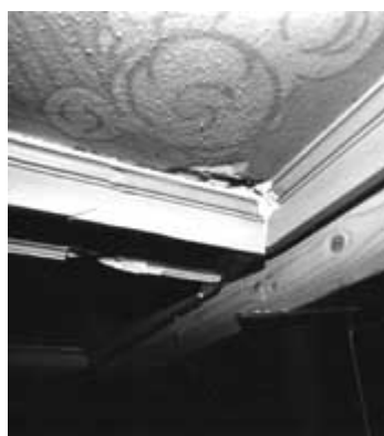
Um assentamento estrutural fez com que este tecto se deformasse. Um engenheiro de estruturas pode escorar o tecto por baixo e voltar a fixar o estuque aos barrotes. Fotografia : arquivos do NPS.
