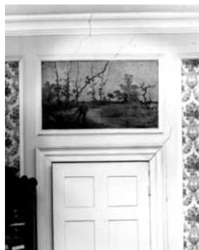
O assentamento do edifício provocou fissuração por tensão quer no estuque liso das paredes quer no estuque ornamental. A reparação da moldura envolve o "alegramento" das fissuras com uma goiva em "V", e a aplicação de remendos com uma mistura de gesso e cal. Fotografia de : Jack E. Boucher, HABS, NPS.
