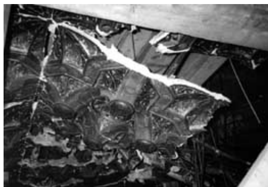
Teatro Yiddish Arts, New York City, c. 1920s. O telhado em betão deste edifício ruiu, danificando partes do tecto em caixotões de estilo Mourisco existente. As unidades de tecto quadradas foram facilmente identificadas e levadas para uma oficina para reprodução. Fotografia de David Flaharty.
