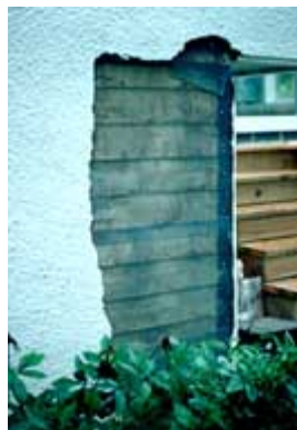
O "stucco" vai ser aplicado sobre o fasciado de arame na área a remendar. Fotografia dos arquivos do NPS.
