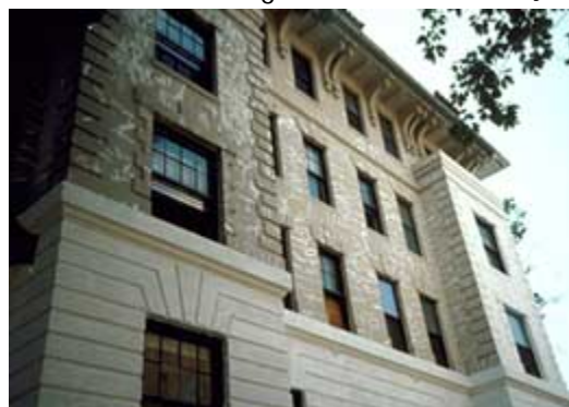
A aplicação (“caulking”) de massas de betumar não é um método adequado para a reparação de fendas no “stucco” histórico. Fotografia dos arquivos do NPS.
