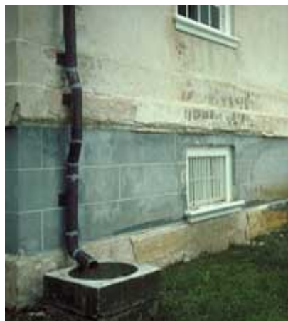
Os danos neste “stucco” aparentam terem sido causados pela infiltração de humidades. Fotografia dos arquivos do NPS.
