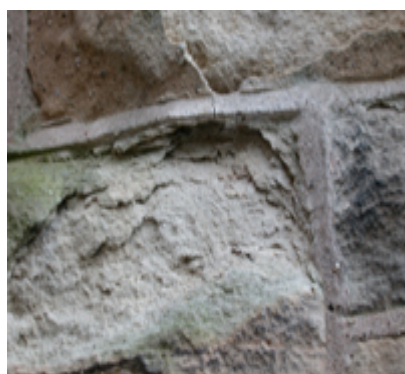
Descamação múltipla de um arenito brando restringido por uma argamassa dura
