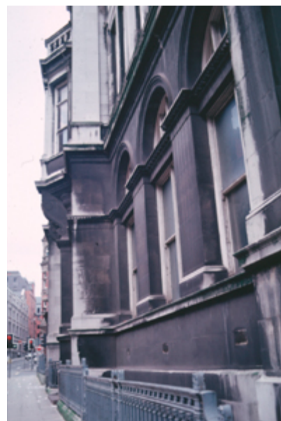
Crosta negra sobre uma fachada em pedra calcária - Liverpool
