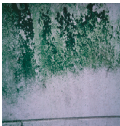
Crescimento de algas sobre pedra de Portland (sazonal)
