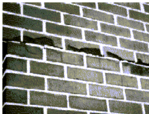
Fig. 6 - Fractura consequente do encurtamento da estrutura
