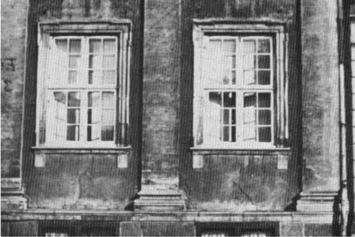
Fig. 59 – Pormenor da fachada : reboco fissurado e descolado
