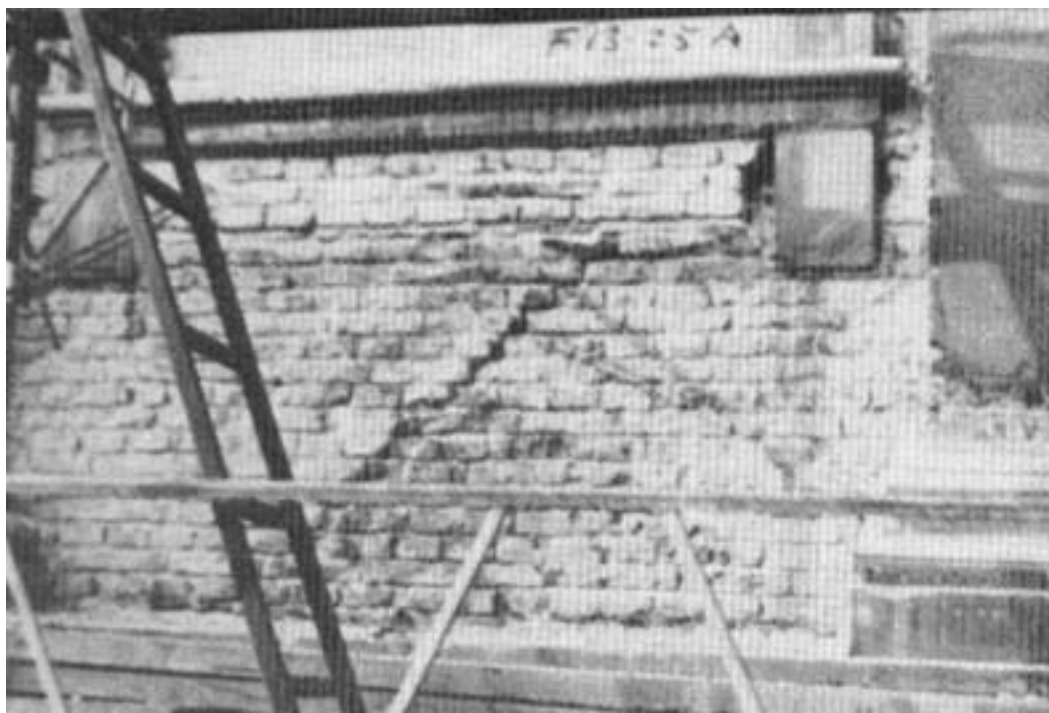
Fig. 61 – Fissura em tijolos postos a nu
