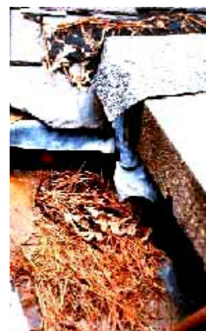
Entulhos que vão impedir o normal escoamento da água proveniente da caleira da cobertura e do seu tubo de queda até ao terreno, e que podem resultar em problemas de humidade. Fotografia : Arquivos do NPS.
