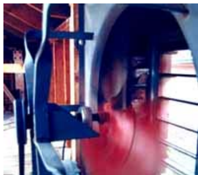
A instalação de ventiladores mecânicos pode melhorar condições de humidade ou reduzir as despesas com o arrefecimento. Fotografia : Arquivos do NPS
