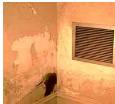
Danos como estes nas paredes interiores podem ser evitados, se for instalada uma adequada ventilação. Fotografia : Arquivos do NPS
