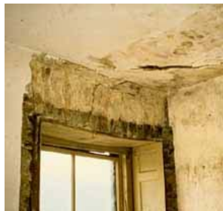
O estuque interior húmido em redor das janelas indica geralmente que entrou humidade proveniente do exterior.
