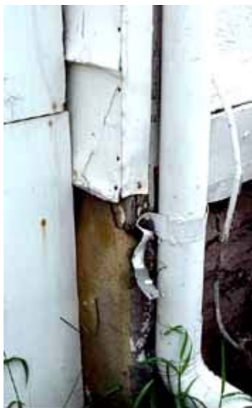
Um tubo de queda entupido ou partido faz com que a água descarregue directamente para o terreno.
