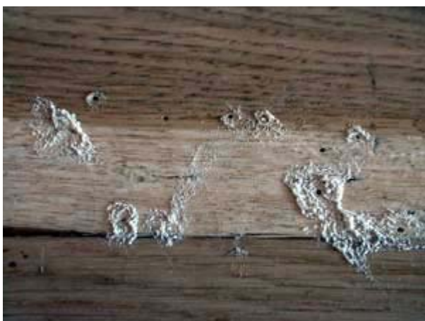
SERRADURA EM REDOR DOS FUROS DE EMERGÊNCIA NUM PAVIMENTO
