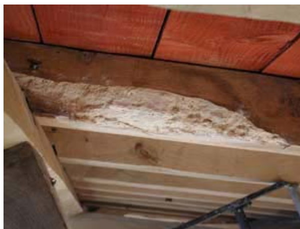
VIGAMENTO DE TELHADO SEVERAMENTE ATACADO
