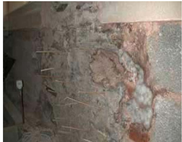
CRESCIMENTO DE PODRIDÃO SECA SOBRE UM TRATAMENTO DA ALVENARIA – FALHANÇO DO TRATAMENTO, E FALTA DE REMOÇÃO DAS MADEIRAS EM CONTACTO COM A PAREDE HÚMIDA
