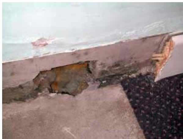
PONTE ATRAVÉS DO ESTUQUE NA LIGAÇÃO PAVIMENTO / PAREDE DA BARREIRA HIDROFUGANTE FÍSICA – BARREIRA HIDROFUGANTE INJECTADA DESNECESSARIAMENTE EXECUTADA
