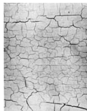
A fissuração – ou fendilhação superficial – é uma condição da superfície exterior que pode ser tratada com sucesso por uma passagem à lixa seguida de pintura. Fotografia : Cortesia da National Decorating Products Association.
