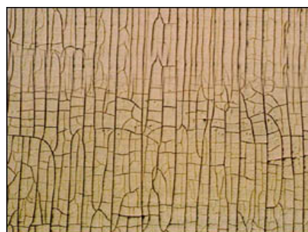
Tinta estalada / “pele de cobra” Imagem proveniente de : http://www.paintquality.com/failures/exterior/alligatoring.html
