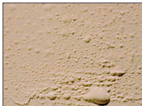
Bolhas de solvente Imagem proveniente de : http://www.paintquality.com/failures/exterior/blistering.html
