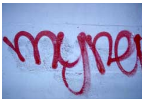
A remoção de graffiti com um jacto abrasivo inadequado imprimiu permanentemente esses graffiti na pedra. Fotografia : Arquivos do NPS
