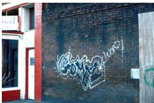
Graffiti pintados a spray desfiguraram este edifício histórico em tijolo. Fotografia : Arquivos do NPS.
