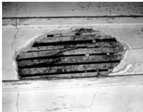
Este tecto trabalhado num dos quartos de cama da Lockwood Huse, de 1847, em Harpers Ferry, West Virginia, tinha lacunas no estuque consequentes de chaves quebradas. Fotografia : Arquivos do NPS.
