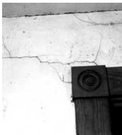
A fendilhação por tensão no estuque sobre a porta de uma cozinha pode ser reparada com rede de fibra de vidro e massa para juntas.
