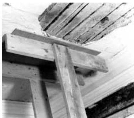
Quando se fazem reparações com estuque fresco ou com uma mistura de colagem injectada, o estuque velho e solto deve ser suportado com um escoramento em contraplacado até estar reposta a chave de ligação. Fotografia : John Leeke.
