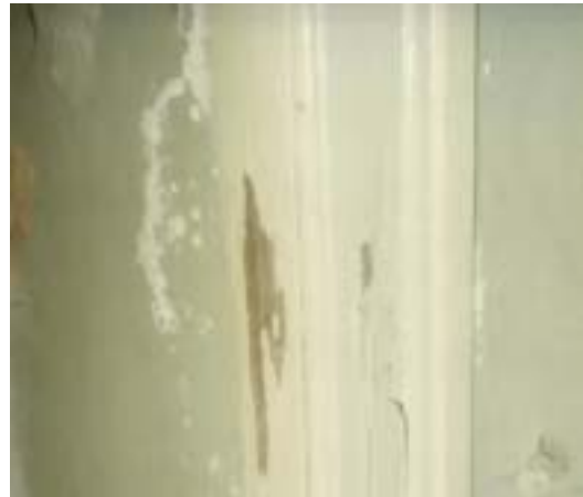
Fig. 2 - Eflorescências em parede exterior de uma igreja setecentista.
