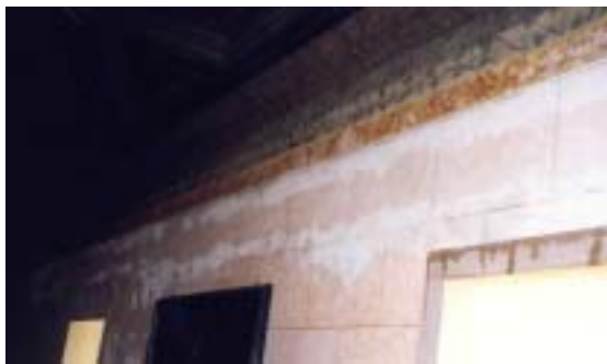
Fig. 3 - Eflorescências surgidas após abertura e tapamento de dois extensos roços horizontais
