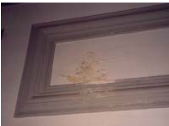
Fig. 1 - Eflorescências em ombreira de vão exterior de um edifício gaioleiro.
