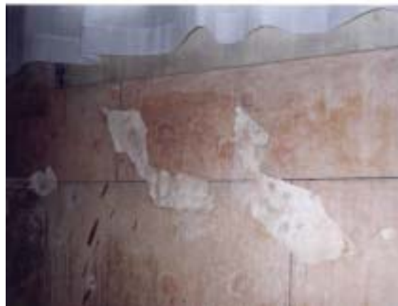
Fig. 4 - Empolamento e desligamento de camada estucada sobre criptoflorescências
