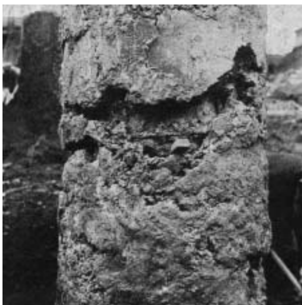
Fig. 27 – Estaca moldada mostrando cavernas. Betão demasiadamente seco.
