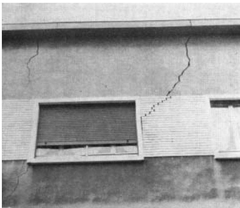
Fig. 31 – Casa construída sobre uma falha
