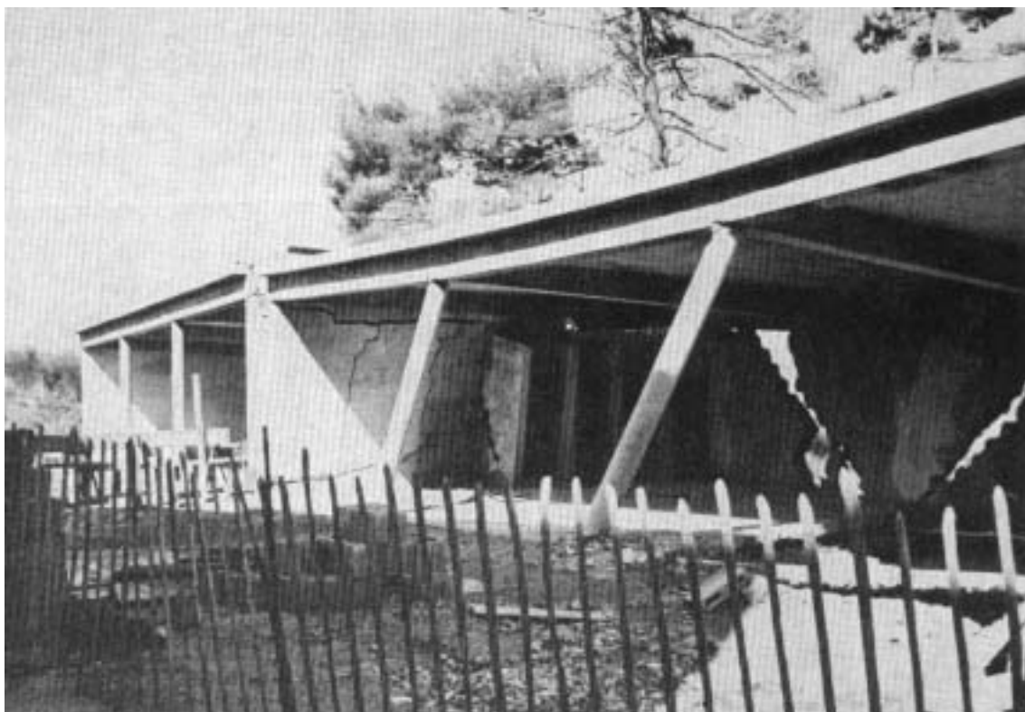
Fig. 6 , 7, 9 e 10 – Estas ilustrações mostram a fissuração, e depois o afundamento de um telheiro de escola fundado sobre aterros de espessura variável
