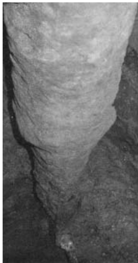
Fig. 42 – Estaca «dilatada» desguarnecida
