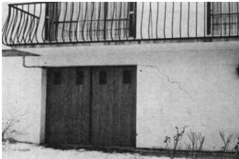
Fig. 11 – assentamento do ângulo de um pavilhão sob a acção das águas de infiltração
