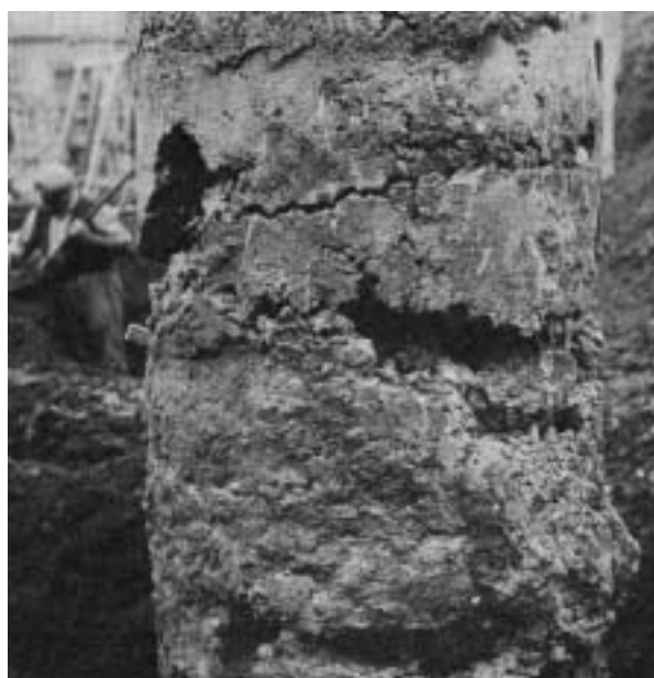
Fig. 28 – Estaca moldada mostrando cavernas. Betão demasiadamente seco
