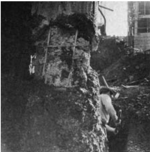
Fig. 29 – Estaca moldada mostrando cavernas. Betão demasiadamente seco
