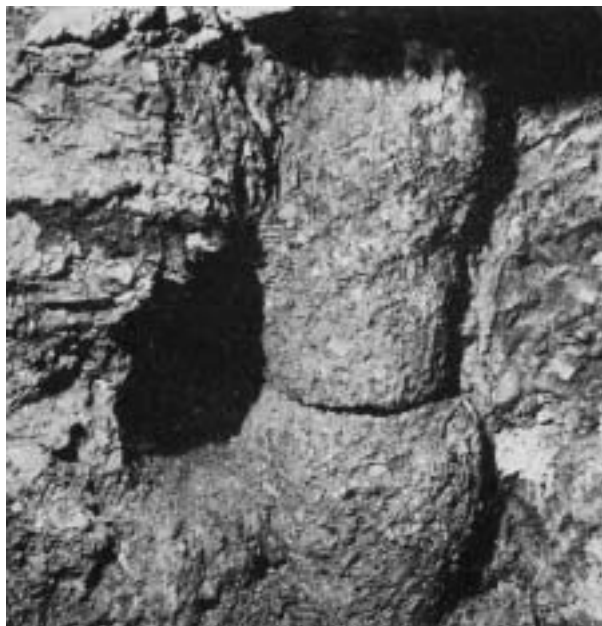
Fig. 26 – Interrupção do betão numa estaca
