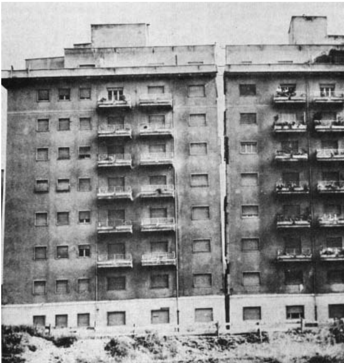
Fig. 23 – Abertura da junta de dilatação de um imóvel fundado superficialmente sobre terrenos muito compressíveis
