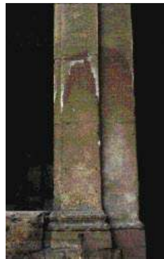
'Linha de maré' de sais solúveis na alvenaria das termas romanas em Bath, provocada pela humidade ascendente. (Professor John Ashurst)
