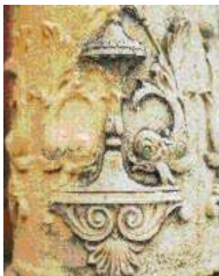
Pilastra em terracota, datando de 1872, e que sofre de sais e de penetração pela humidade, exacerbadas pela aplicação de uma tinta. É visível uma eflorescência salina branca na superfície degradada da terracota, que está perfurada e friável.
